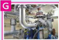
+ 高圧代替注水ポンプ (制御電源不要)
